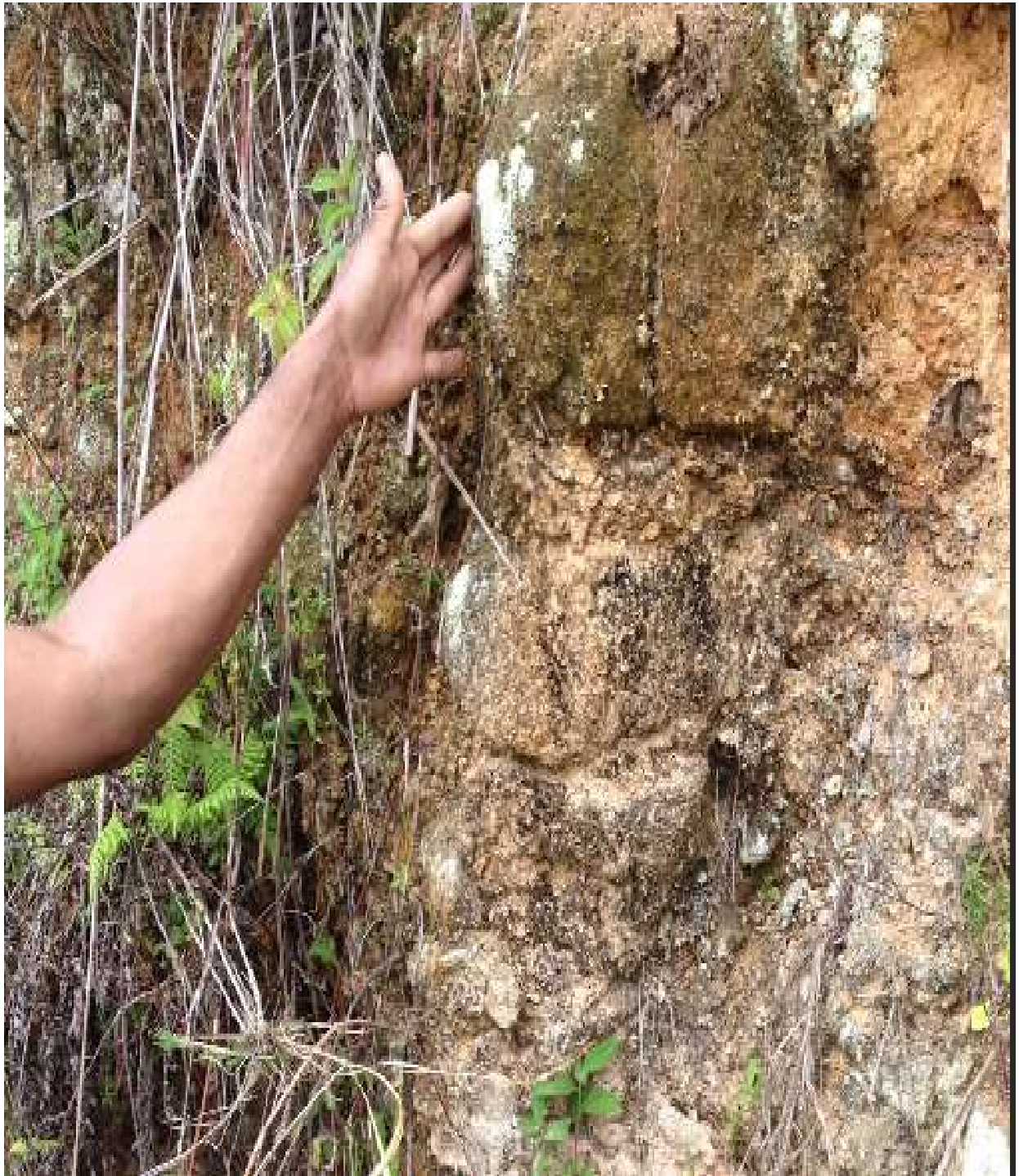
Estrutura do aqueduto que captava e levava água do rio para as calhas do Engenho de Santana e suas rodas d'água
